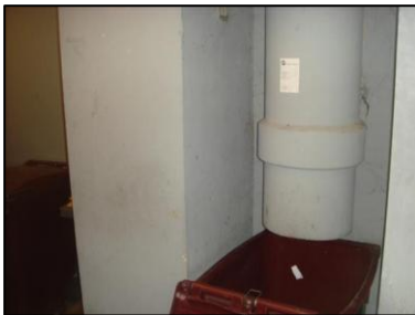
Photo N° 6155 AMIANTE CIMENT - -LOCAL VO RDC à +4 Vide-ordures Gaine V.O.(Fibres-ciment)
